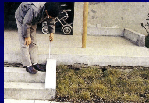
完成後1年で、団地の入口に16cmの落差 (「日本の平野」平凡社より)
